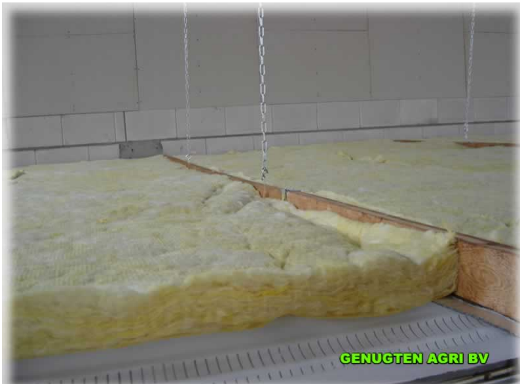
De afbeelding toont een close-up van een ventilatieplafond in een stal. Het systeem bestaat uit gele isolatieblokken die zijn geplaatst op een houten frame, met een witte, perforated metalen grille erop. De afbeelding is watermerkt met 'GENUGTEN AGRI BV' in groene letters.
